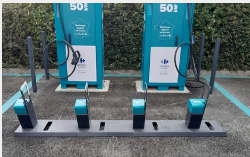
Attribution : Bornes de recharges pour 2 roues électriques (Chargemap)
