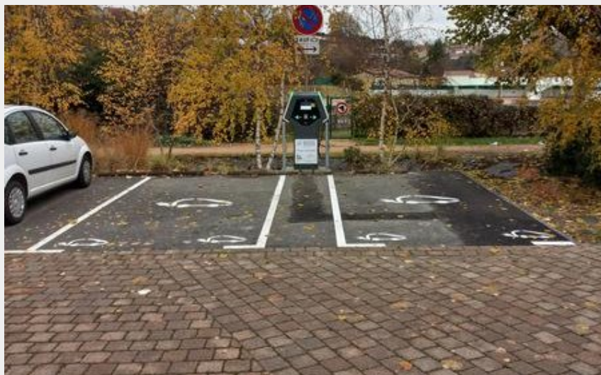
Crédit : Borne de recharge véhicules électriques Châtel-Guyon_Châtel-Guyon (semelec 63)
