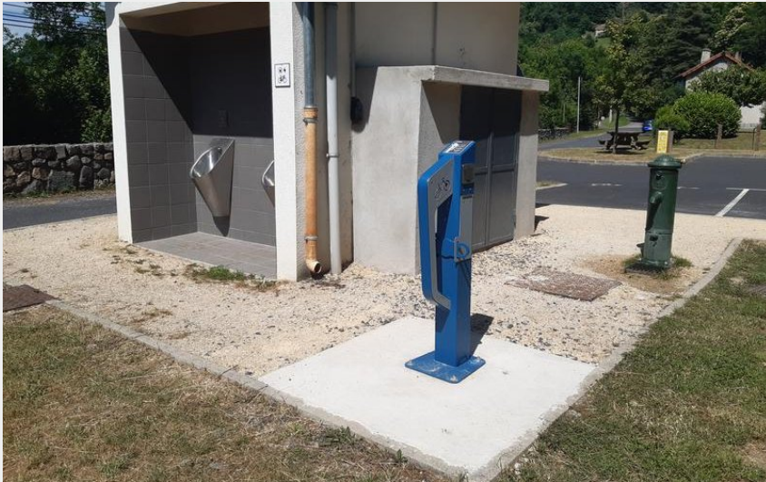
Crédit photo : Borne de recharge (ADHV)
