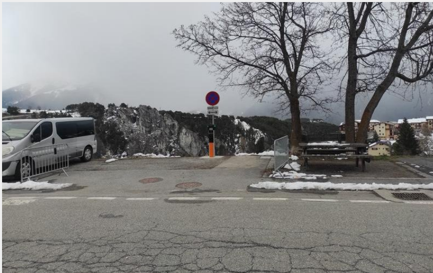
Crédit photo : Borne de recharges électrique Aussois (CCHMV)
